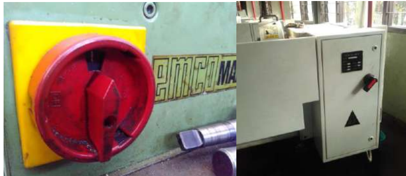
Gambar Saklar pemutus arus dari sumber arus listrik menuju mesin bubut
