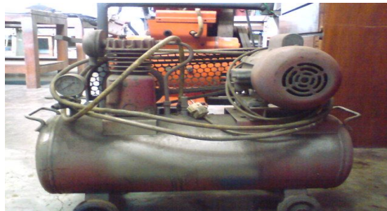
Gambar 21. Compressor di bengkel listrik
