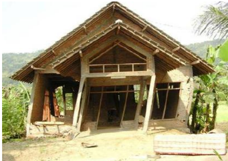
Gambar 8. Deformasi Bangunan Akibat Gempa Bumi
